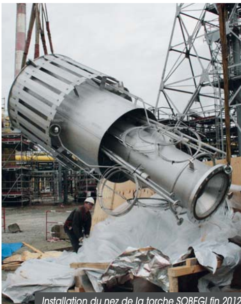
Installation du nez de la torche SOBEGI fin 2012.
